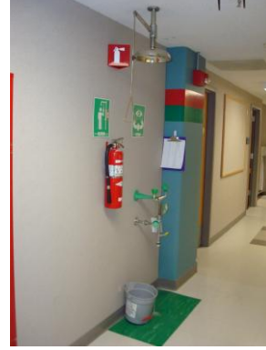
Duş ve göz yıkama ünitesi
